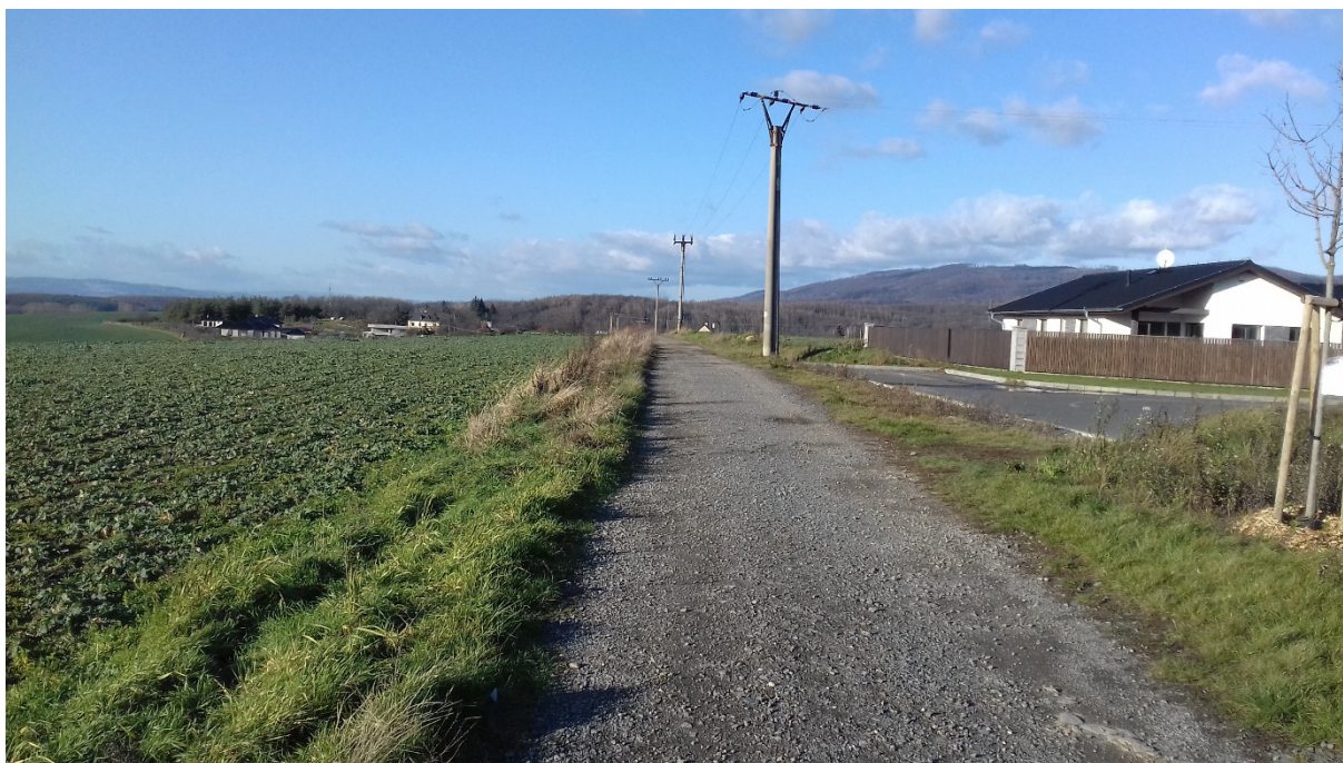
Obr. 7 – nadzemní elektrické vedení u ulice Přikrylova
