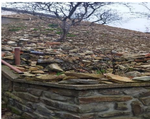
Kontrola- stavební suť x stromy
