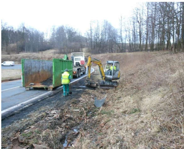
Sanace havárie nad Lipinou - únor 2020
