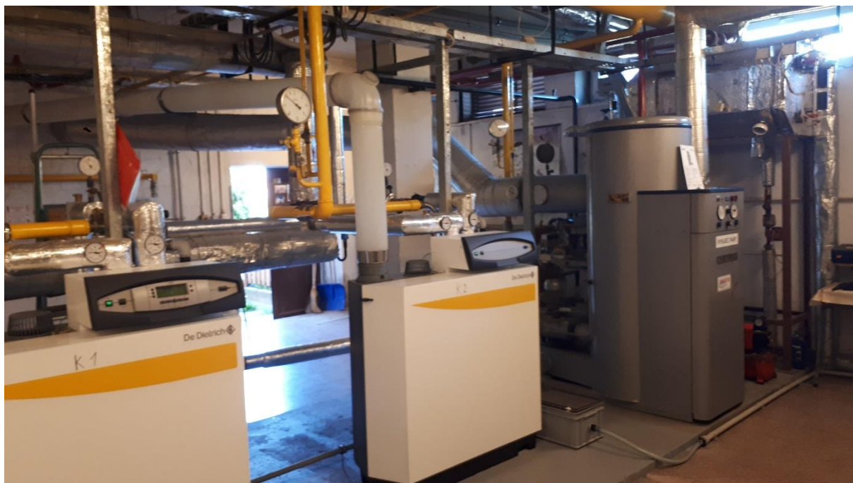
Kotelna ZŠ Svatoplukova – Úprava expanzního systému
